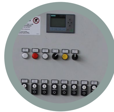
Πίνακας για τον έλεγχο της λειτουργίας μέσω PLC.
